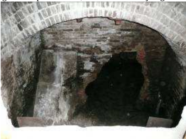
Pompkelder gemaal Maasbommel
