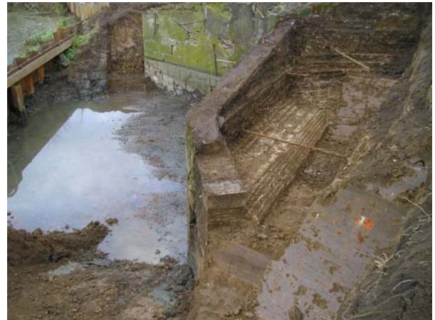
Het sluiscomplex is drooggezet en gedeeltelijk afgegraven. Dit levert uniek fotomateriaal op. (zie onze website)
