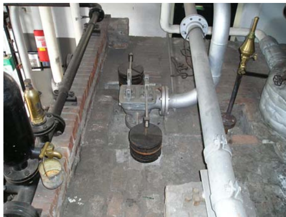
Rechts op de foto de Blackfluit die alarmeert indien het waterpeil in de ketel te laag wordt.
