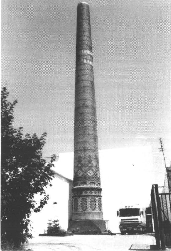
Afb. 1. De schoorsteen van Jansen en Tilanus in Vriezenveen, gebouwd van gele steen met rode versiering, een unieke kleurstelling, waar geen tweede van bekend is. Gebouwd rond 1920, momenteel buiten gebruik, in matige staat van onderhoud. De bovenste meters zijn in het verleden gesloopt: de hoogte is nu nog ongeveer 45 meter.
