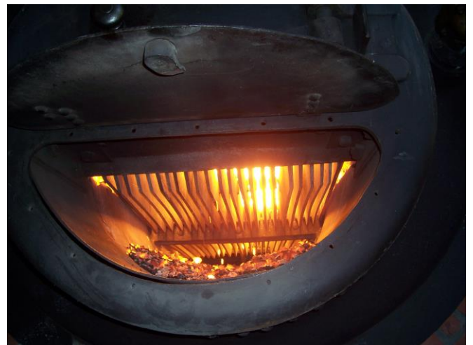
De roosterijzers onder het vuurbed
